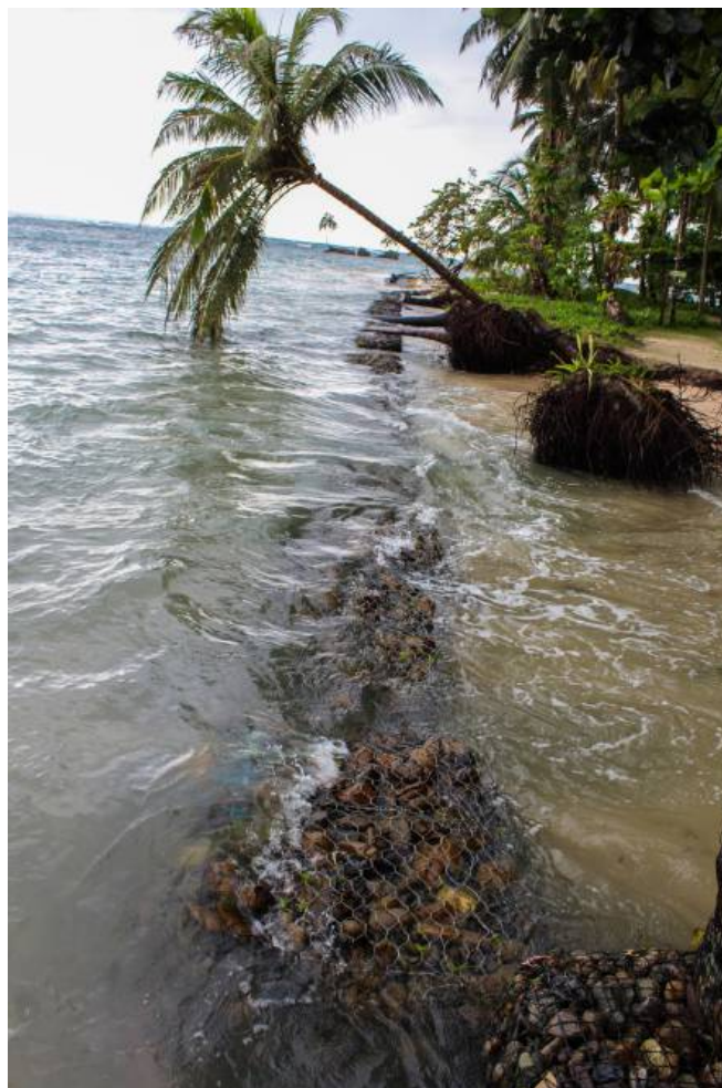
Figura 34. Región Caribe Occidental. Isla Zapatilla, Bocas del Toro. Se observa la colocación de gaveones para contener la constante entrada del mar.
